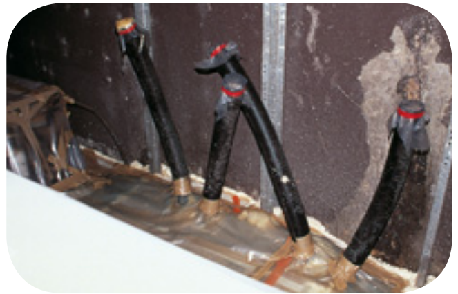
Installation électrique mise hors-service et gaine de passage obstruée.
