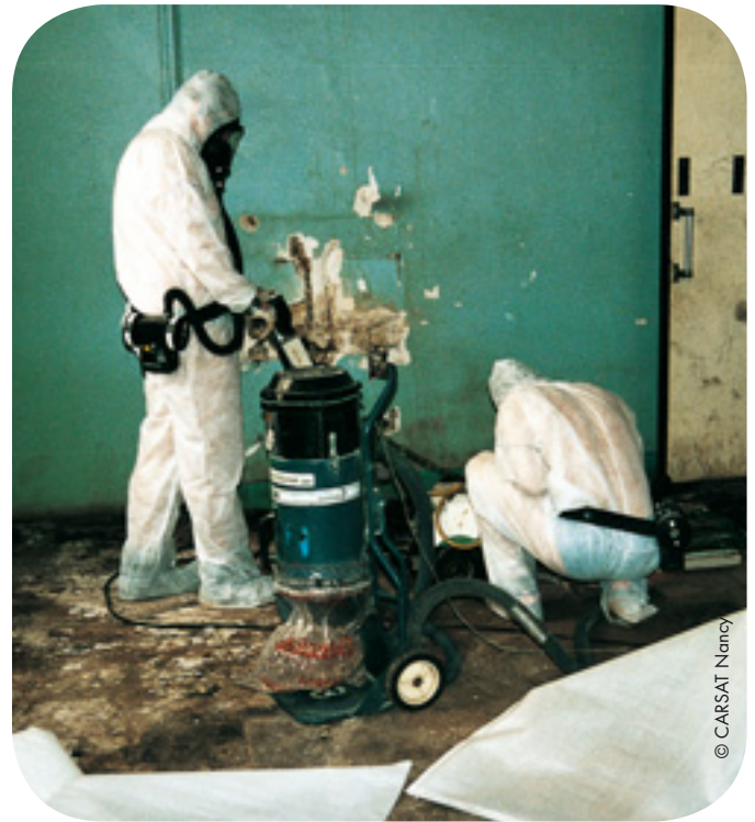
Décollement des dalles sous aspiration.
