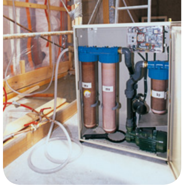
Ensemble de filtration d'eau.
