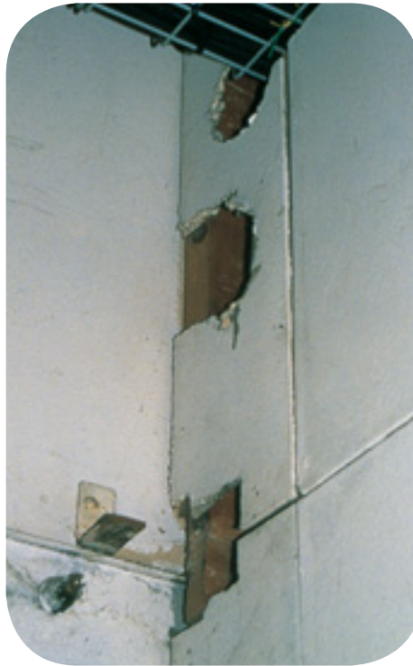
Plaques de carton d'amiante.
