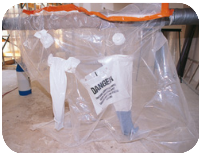
Sac à gants pour le confinement d'une portion de canalisation horizontale.
