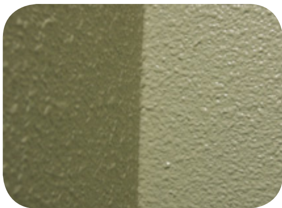
Peinture « gouttelettes » amiantée.
