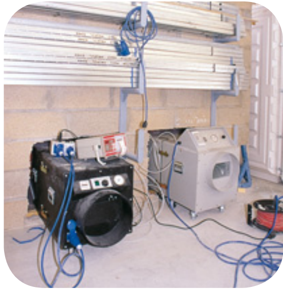
Extraction de l'air filtré et dispositif externe de contrôle de la dépression.
