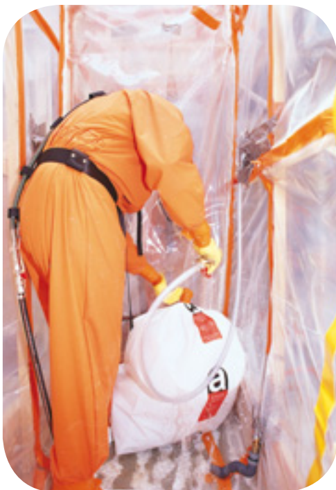
Le sac de déchets, étanche, fermé et marqué, est douché avant sa sortie de zone.
