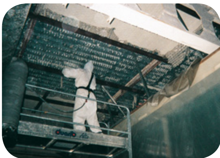
Retrait d'un enduit plâtreux projeté.
